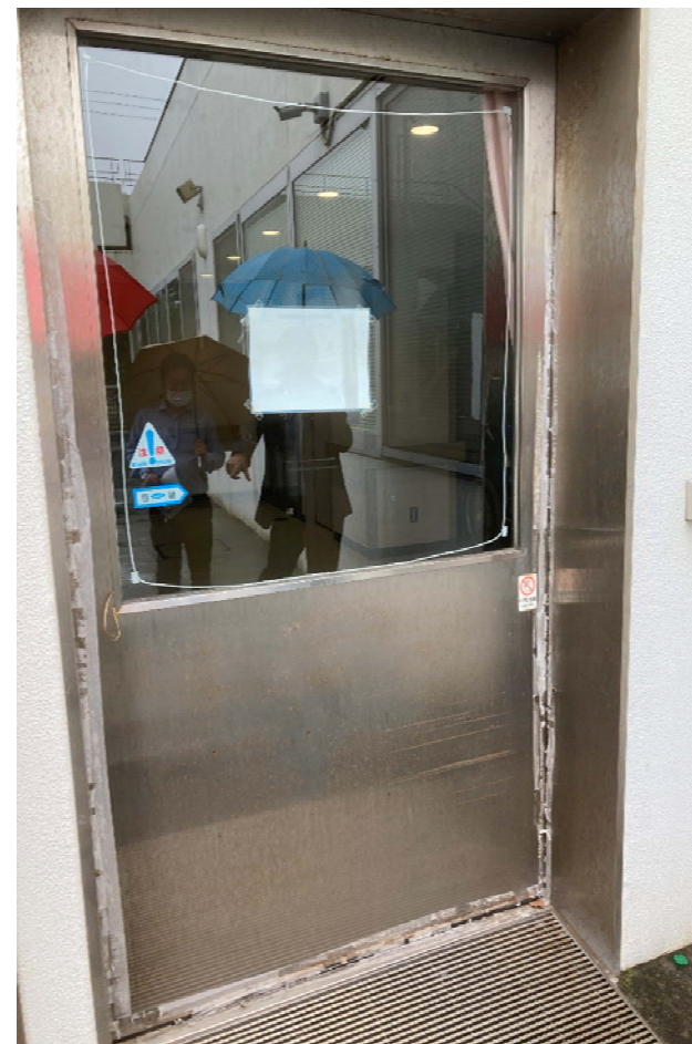
【写真3】西棟外扉が開閉困難
