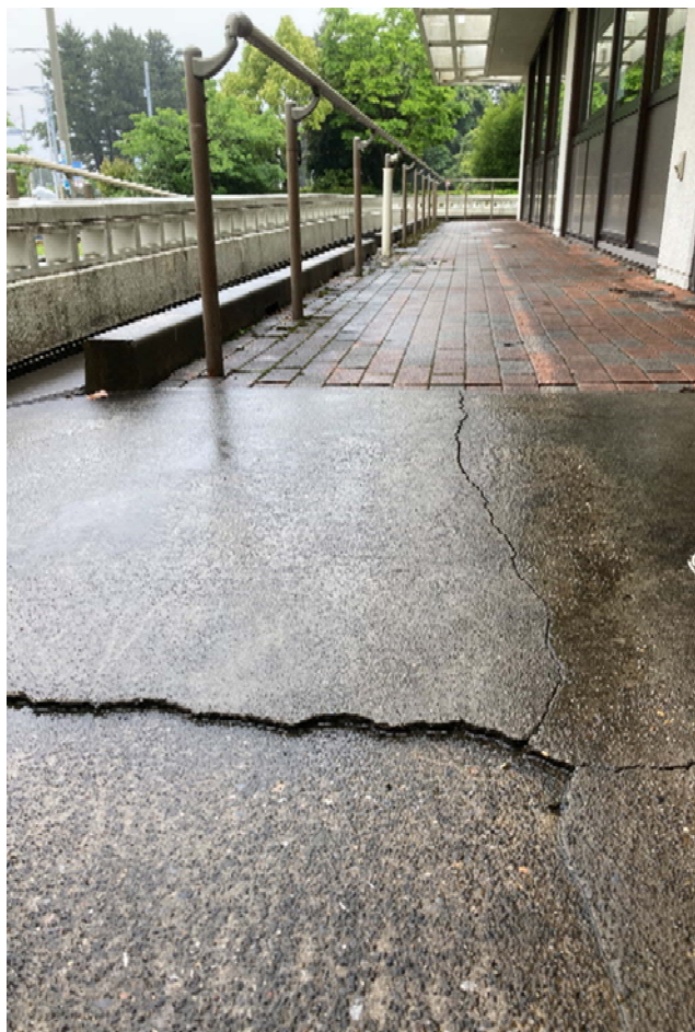
【写真1】西棟南側通路に亀裂
