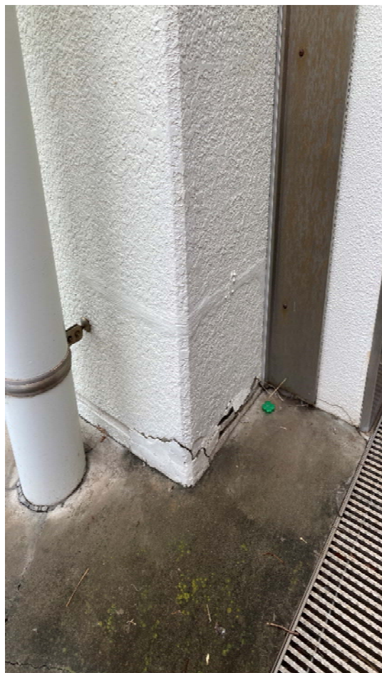
【写真2】西棟外壁にひび割れ
