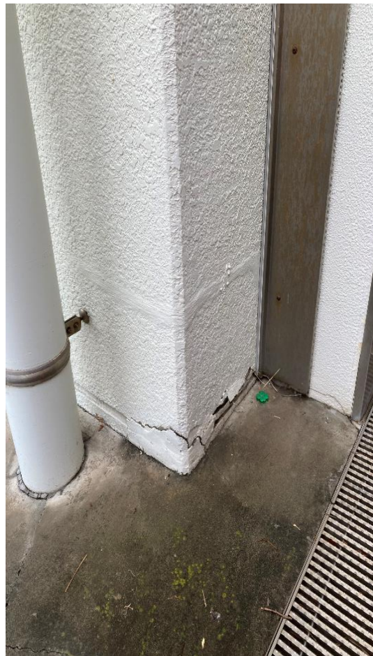
【写真 2】 西棟外壁にひび割れ
