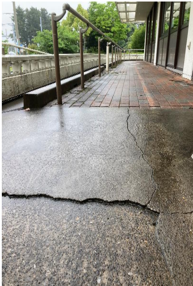
【写真 1】 西棟南側通路に亀裂
