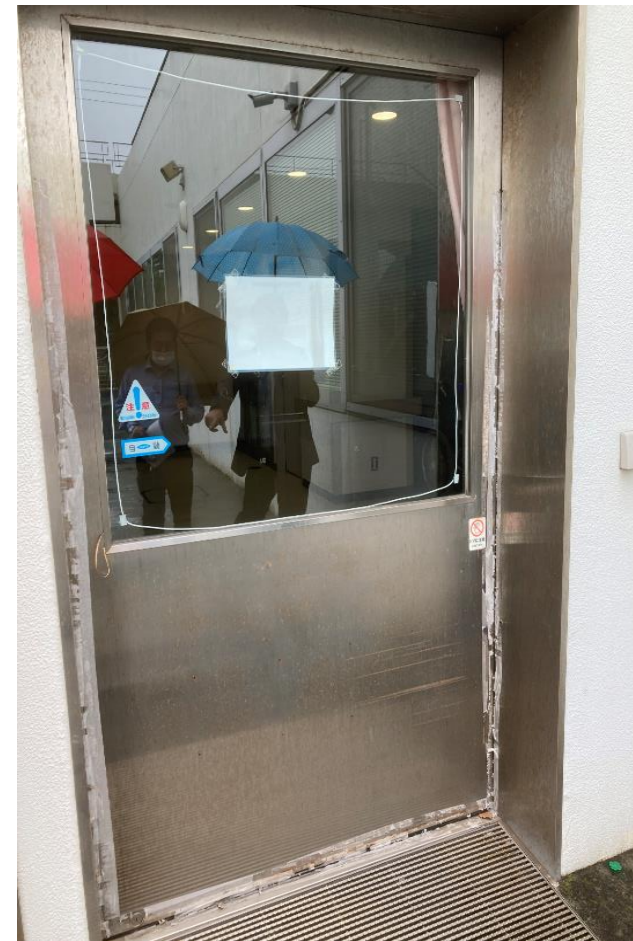
【写真 3】 西棟外扉が開閉困難
